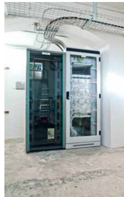
Serverraum im Untergeschoss (U-08)
